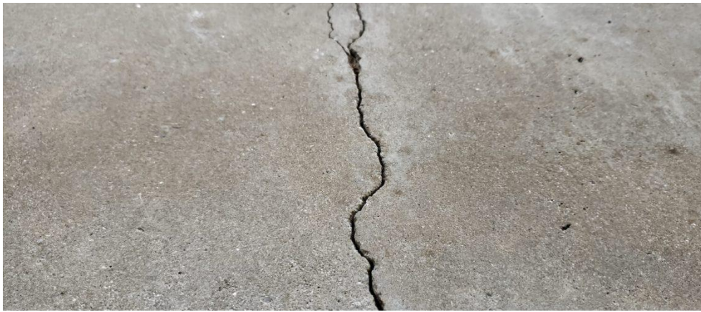
شکل ۲: ترک‌های سطح بتن ناشی از تبخیر سطحی آب
