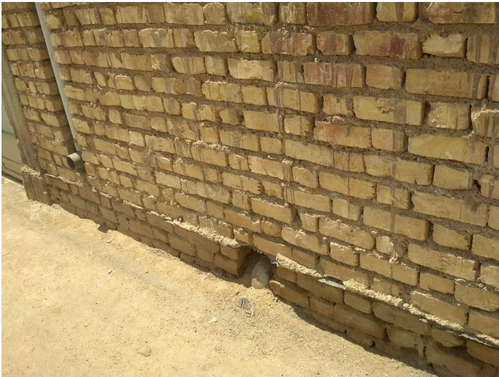
شکل ۲: اختلاف تراز روی کرسی با معبر مجاور ساختمان
