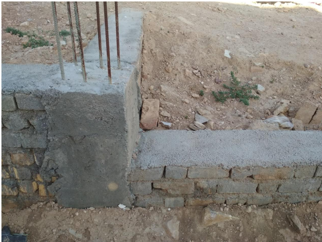
شکل ۲۰: بالاتر بودن تراز کف ساختمان نسبت به تراز حیاط
